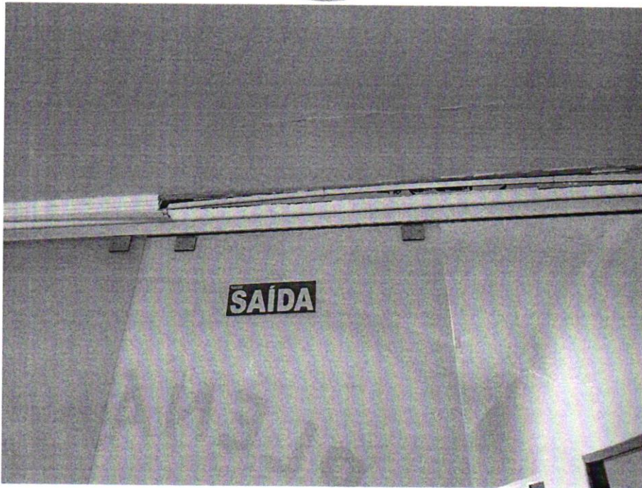
FOTO 18 – FORRO DE GESSO TRINCADO
