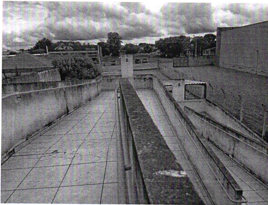
FOTO 19 – RAMPA DE ACESSO AOS PNE, EXTERNA E EM PÉSSIMAS CONDIÇÕES
