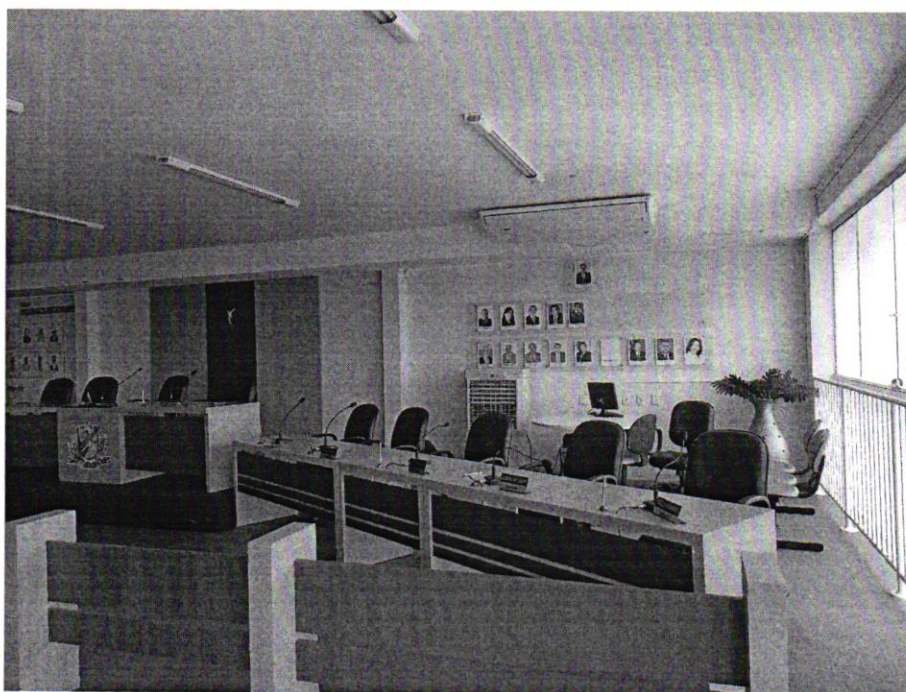
FOTO 17 – VISTA DO PLENÁRIO COM INFILTRAÇÕES
